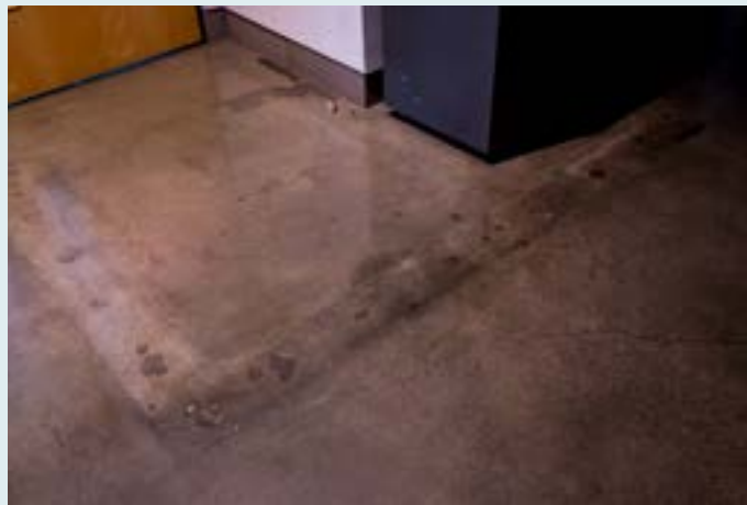
Marques laissées lors du déplacement d'un mur. Photo : Antoine Saito.
