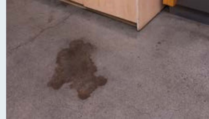
Tache brune présente dès la fin des travaux. Photo : Antoine Saito.
