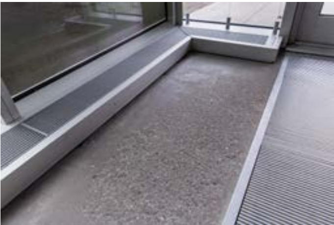
Détérioration dû au sel de déglacage. Photo : Antoine Saito.
