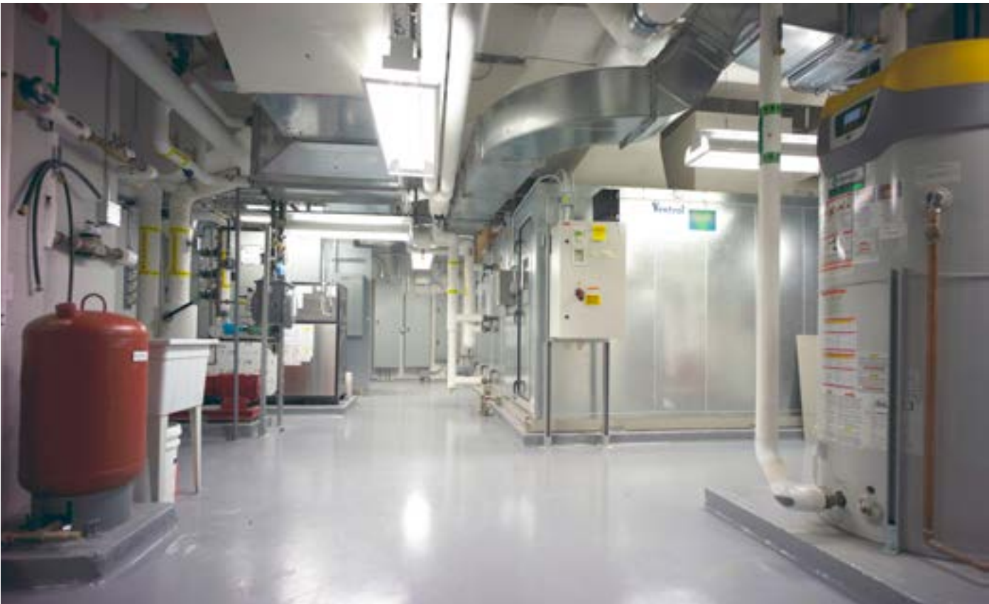
Salle mécanique du 5 e étage. Photo : Bernard Fougère.
