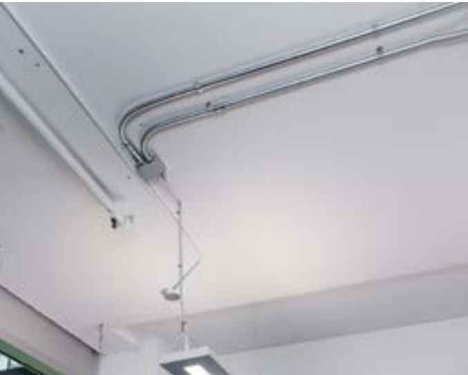
Conduits électriques non peints lors de réaménagements. Photo : Antoine Saito.
