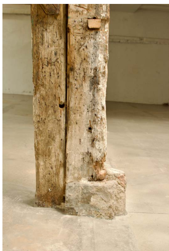
Forte dégradation par agent biologiques au pied de poteau
