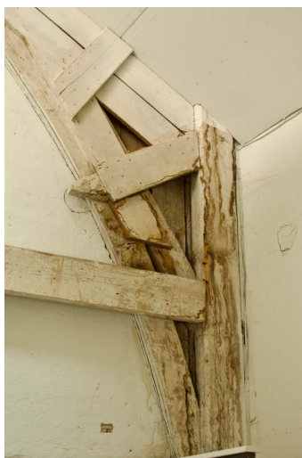
Traces d'humidité/infiltration et noircissement du bois
