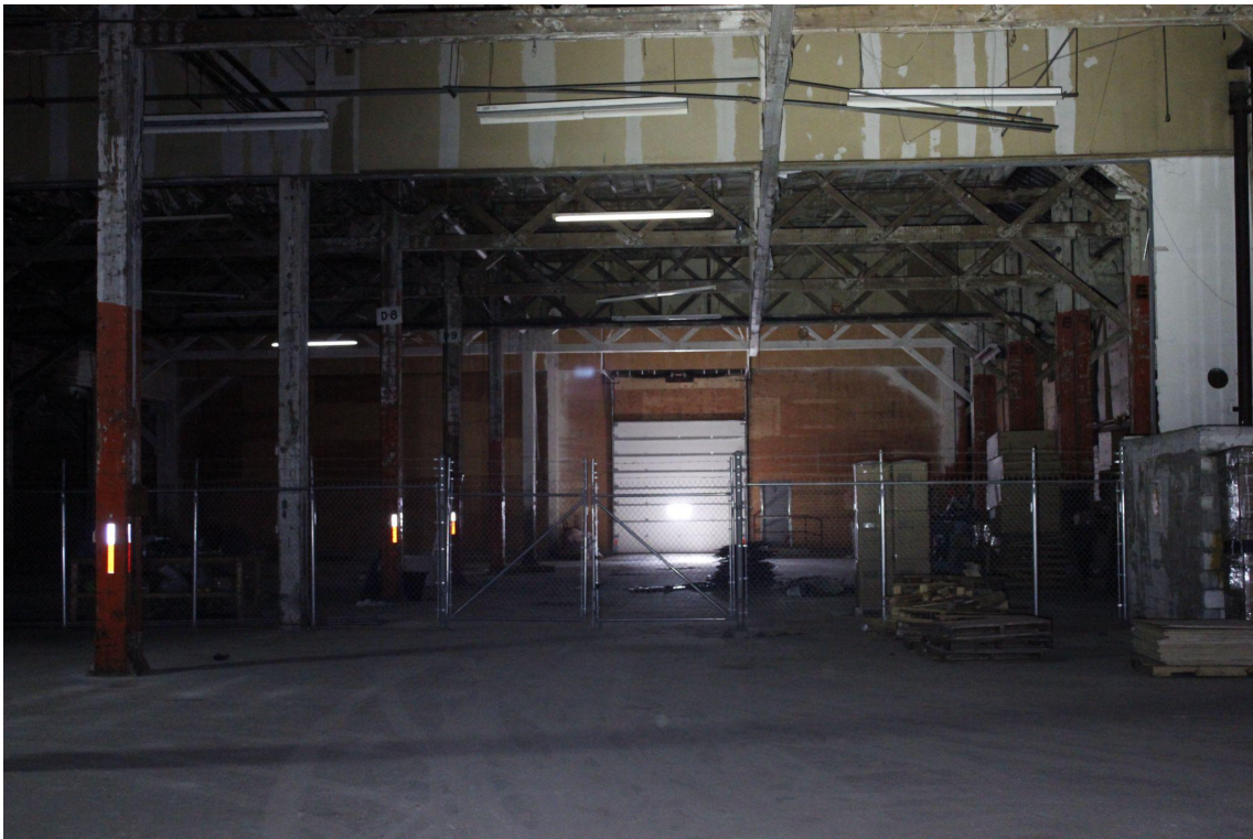
Section arrière détruite par l'incendie
