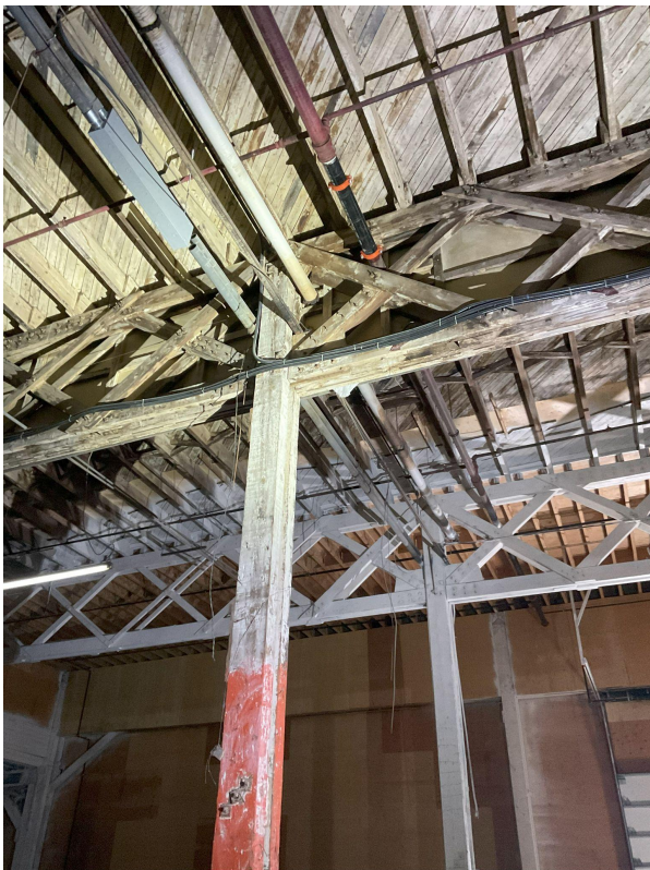
Multiples conduits et réseaux
