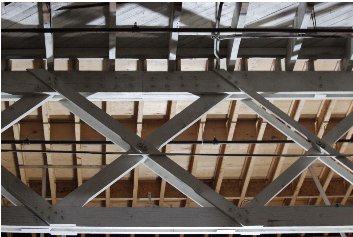
Raccord de structure suite à l'incendie
